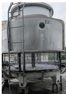
冷卻水塔散熱鰭片
