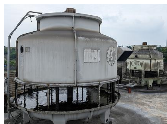
冷卻水塔風扇及幫浦和 冷凍機同步
